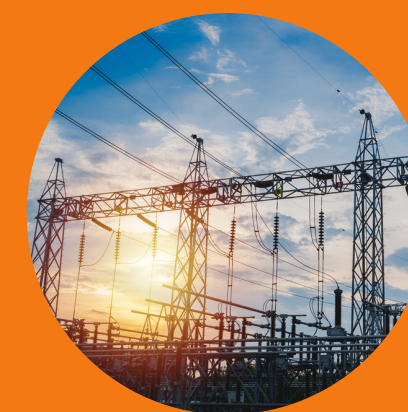
Linhas de transmissão Redes de distribuição Subestações elétricas
